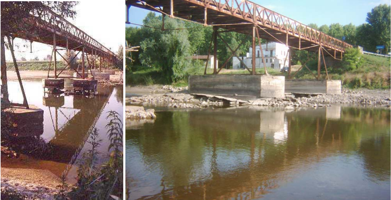
Ponte sull'Oglio (Acquanegra sul Chiese) a metà degli anni '90 e a giugno 2006: a causa dell'abbassamento dell'alveo erano stati rinforzati i piloni di sostegno, ma a distanza di pochi anni, non essendo state rimosse le cause, l'erosione di fondo continua tendendo a scoprire anche i "nuovi" e più potenti interventi.
